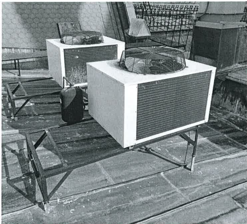
a tetőre telepített kondenzátorok jelenlegi elhelyezése
